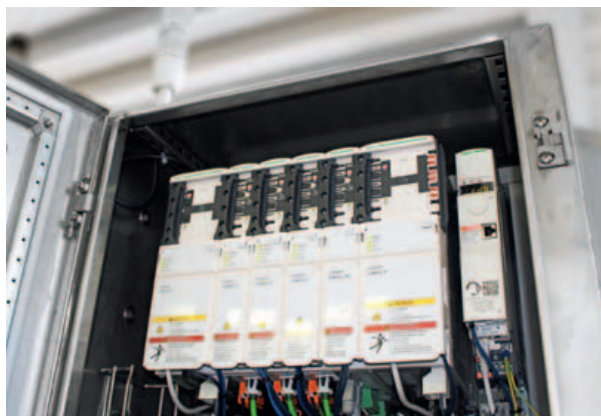
Un quadro elettrico della macchina
