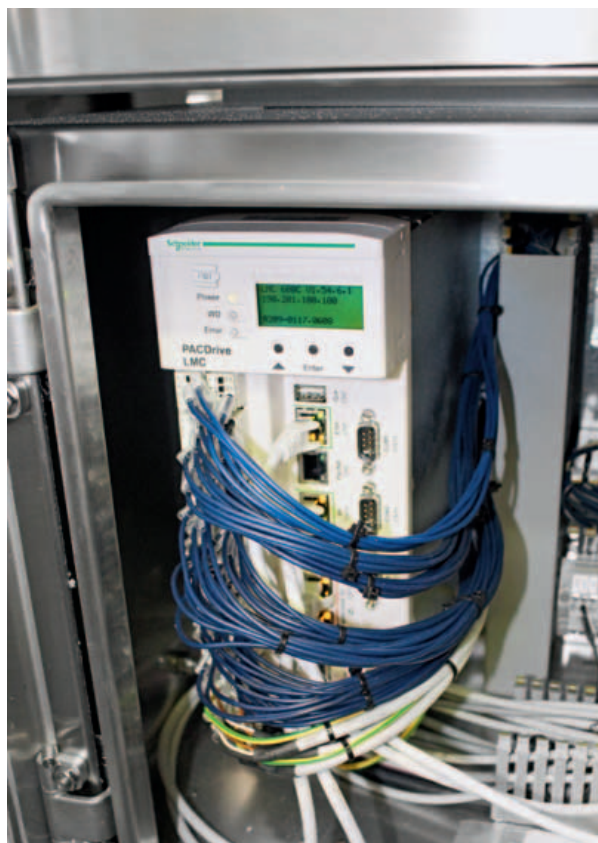
Il sistema di controllo è basato sull'architettura PacDrive 3 di Schneider Electric
