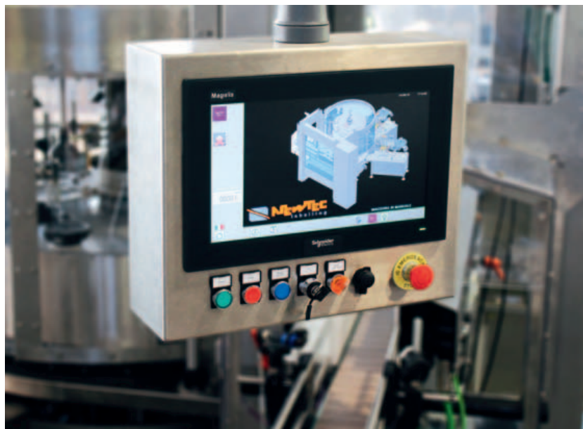
Un sistema HMI Magelis consente la gestione della macchina e del sistema di visione
