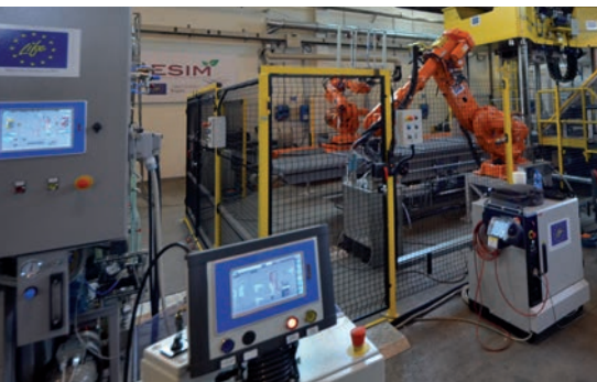
L'impianto di produzione di elementi compositi a base di fibra di carbonio del progetto Cresim, realizzato da Automata-Afros
