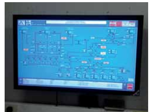
Figura 3 - Il monitor sinottico installato nelle stazioni locali
